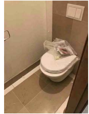
(full bath# 6 -toilet)
